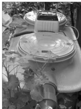
液肥化槽 (浄化槽)
