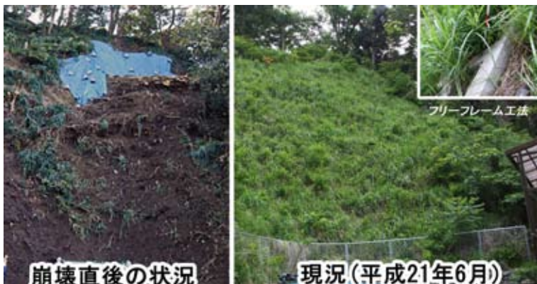
写真-2 斜面崩壊当時の状況と現況
