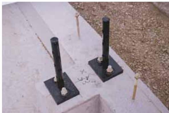
布基礎のボルトと専用柱脚金物
